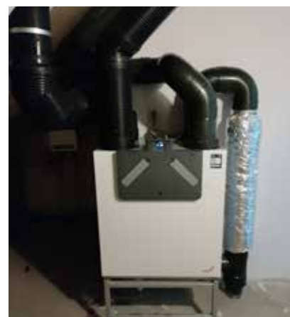
Ventilatie-unit op zolder
