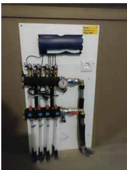
Vloerverdeler 1e en 2e verdieping
