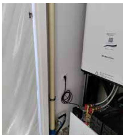
Douche wtw en boiler
